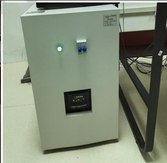
UPS 应急电源
